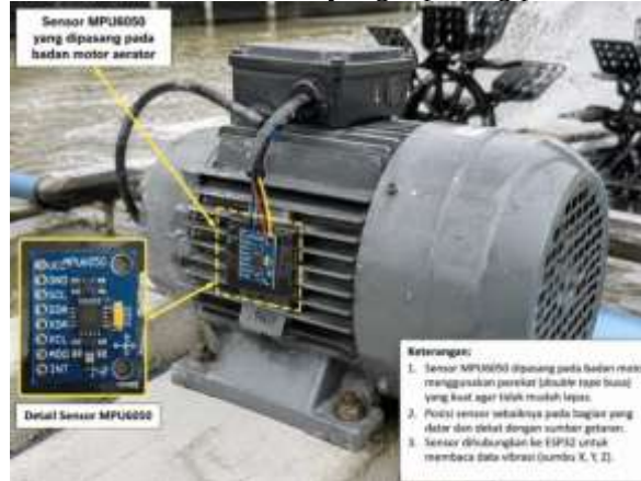
Gambar 1. Sensor MPU6050 yang dipasang pada badan motor aerator.
