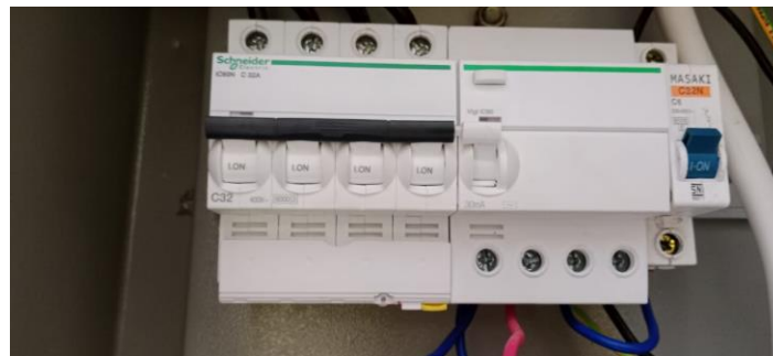
Gambar 5. MCB dan ELCB pada Ruangan Laboratorium SMK Negeri 1 OKUS
