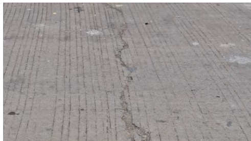
Gambar 1. 2 Kondisi Retak Memanjang Melintang Sumber: Dokumentasi Pribadi 2025
