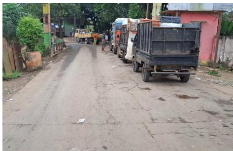
Gambar 1. 3 Kondisi Kerusakan Jalan Akibat Truk Sumber: Dokumentasi Pribadi 2025
