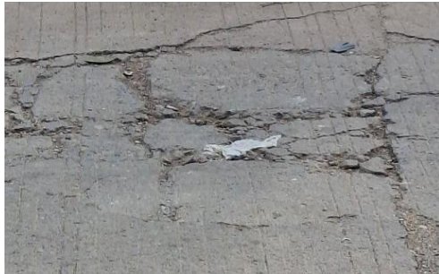
Gambar 1. 1 Kondisi Kerusakan Retak Buaya Sumber: Dokumentasi Pribadi 2025
