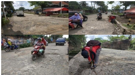
Gambar 4. Kondisi Existing Ruas Jalan Sako Baru di beberapa STA
