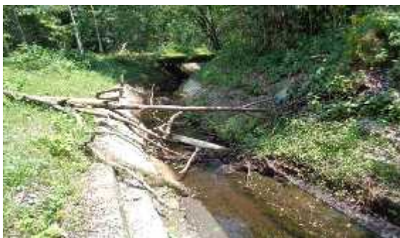
Gambar 3. Kondisi saluran yang rusak
