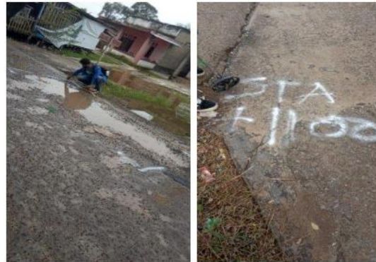
Gambar : 3.1 Survei Kerusakan Jalan
